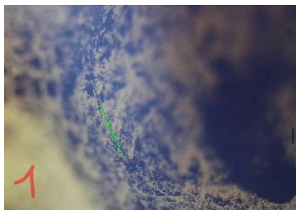
Slika 3 Površina oštećenja (zeleno) koju računa program Python
